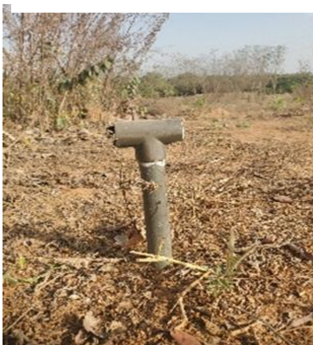
Photo 6 : Tuyau en T de dérivation pour amener vers les parcelles
