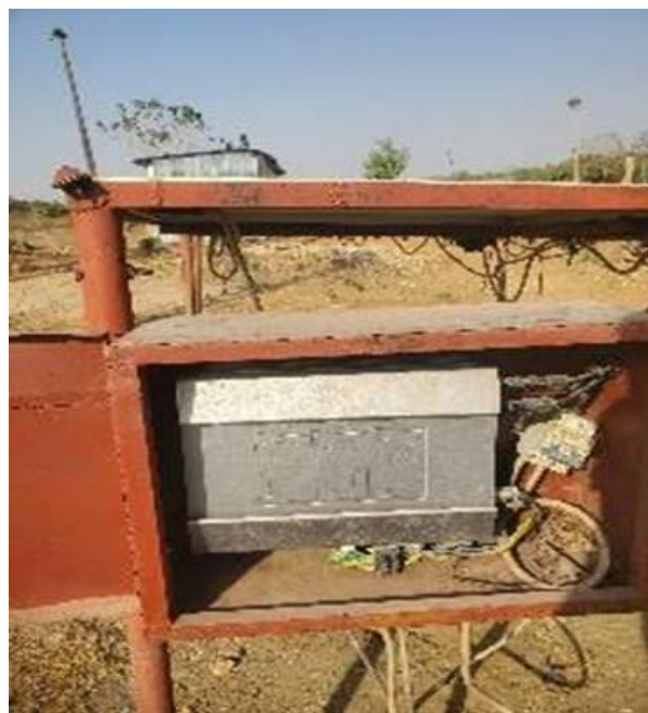
Photo 7 : Convertisseur de l'énergie solaire captée par les plaques solaires en énergie électrique pour la pompe hydraulique
