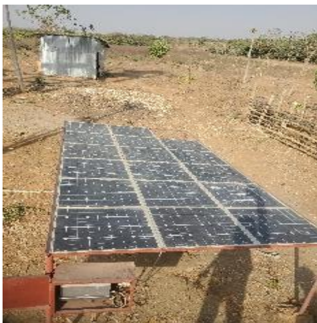
Photo 4 : Plaques solaires d'alimentation en énergie de la pompe
