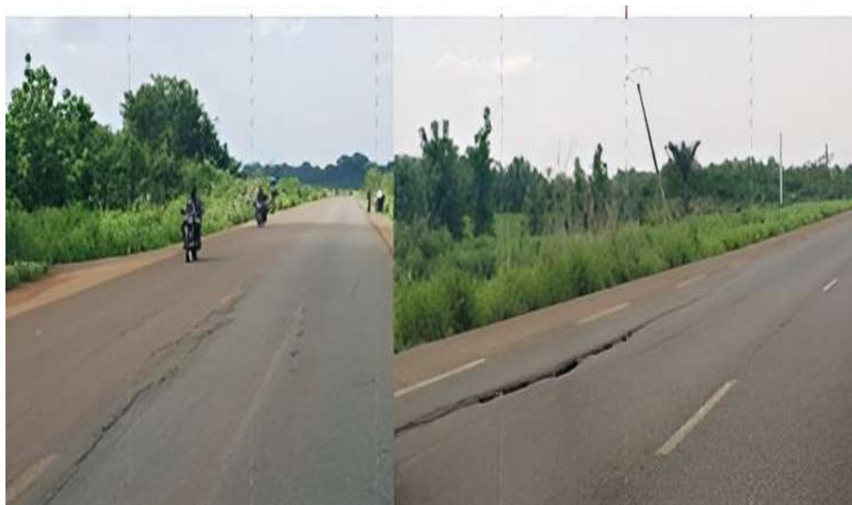
Figure 3- 3 : Fissuration longitudinale au niveau du PK 2
