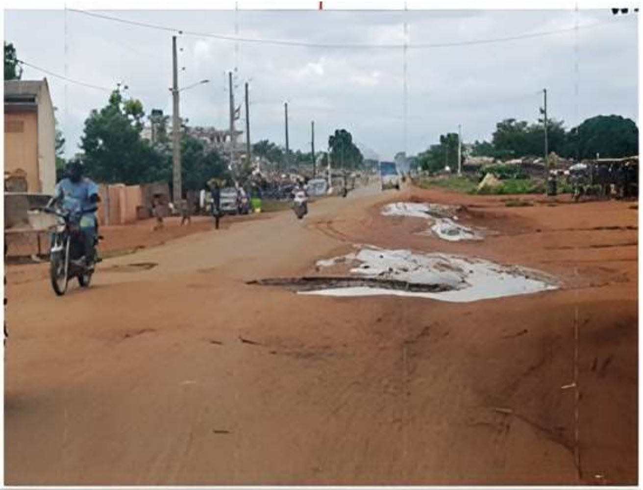
Figure 3- 1 Nid de poule observé au niveau du 0+725
