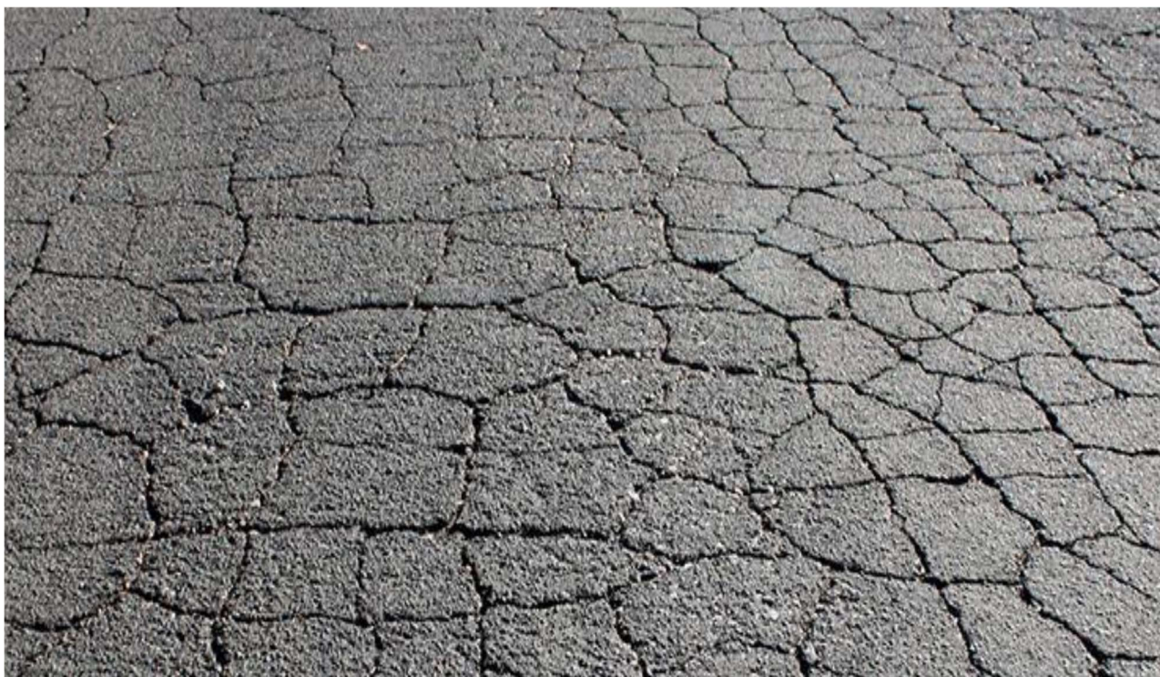
Figure 3- 2 Faiëncage observé au niveau du PK 1+250
