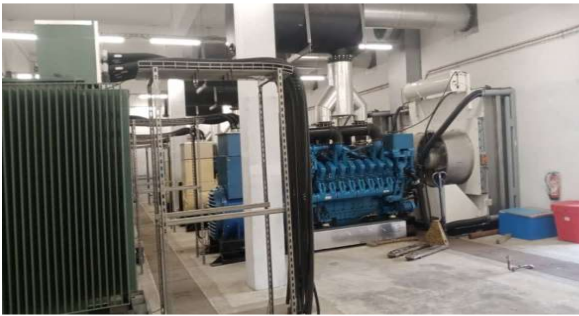
Figure 3.4 : vue d'ensemble d'installation de tous les Equipment nécessaires pour le fonctionnements d'un groupe
