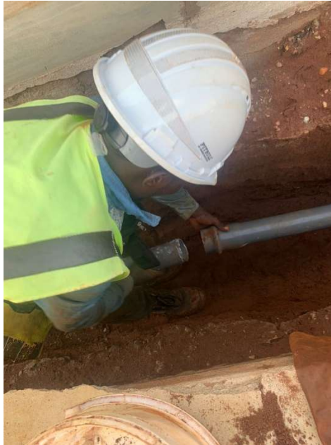
Photo 1 : Ensemble de deux tuyaux PVC
